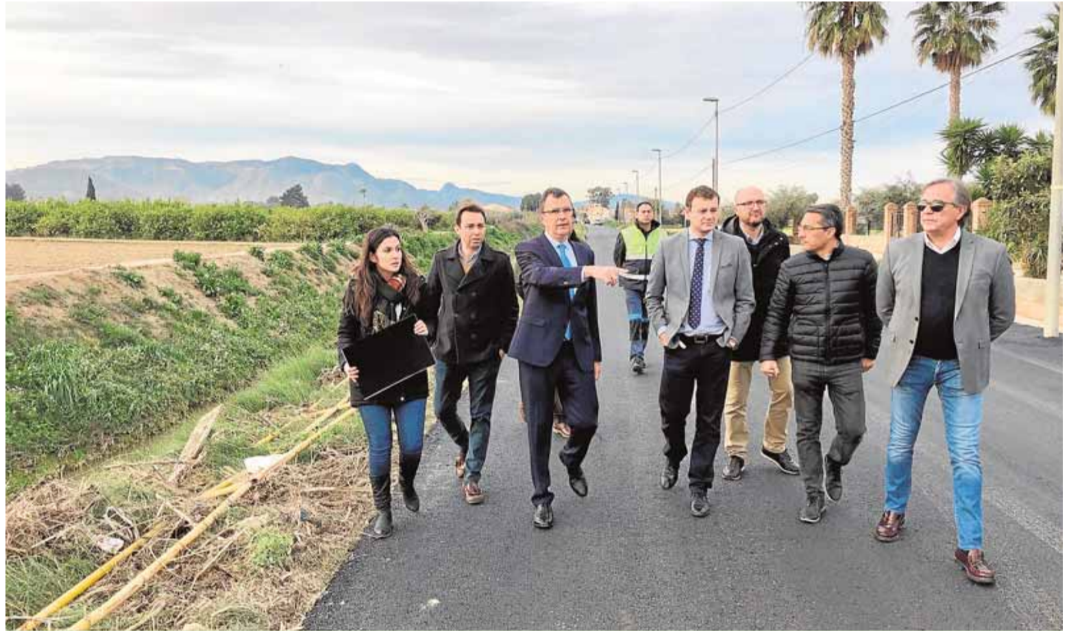
El alcalde José Ballesta y el concejal Marco Antonio Fernández durante una visita a las obras de Alquerías. Fotos: Ayto. de Murcia
