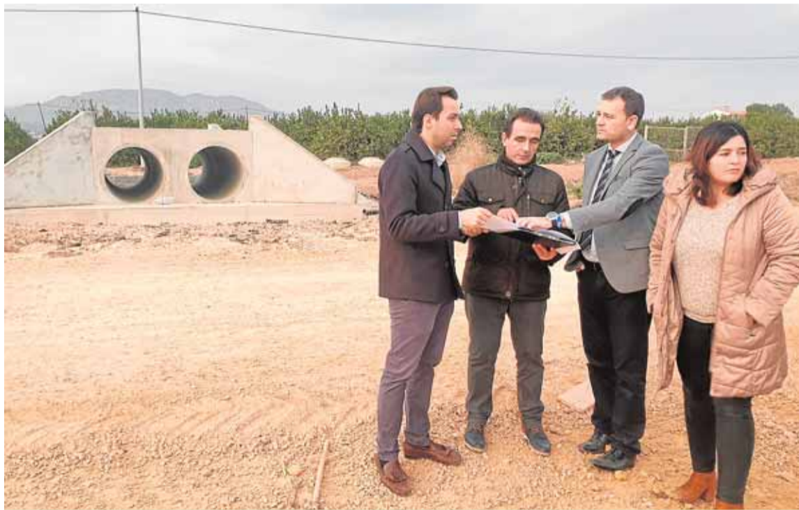
El concejal de Pedanías visita las obras que se están acometiendo en la carretera F19 en Gea y Truyols.
